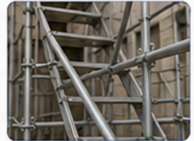
Merdiven ve geçiş yolları güvenli olmalı.
