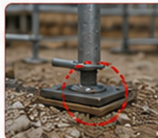
Zemin düzgün değil, iskelenin oturması riskli.
